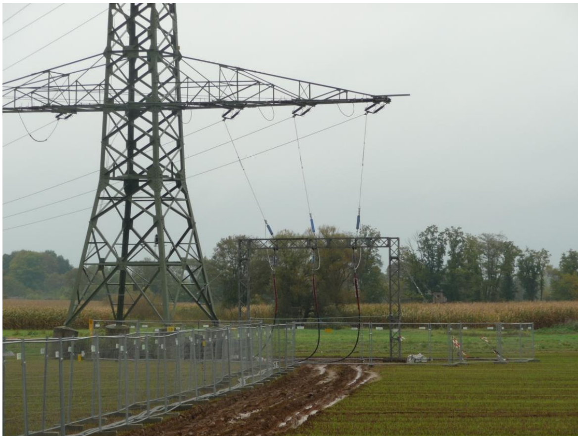
Abbildung 45 Abbildung 43 : 110-kV-Kabelprovisorium mit Übergangportal
