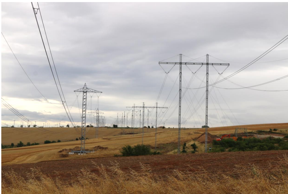
Abbildung 43 Abbildung 41 : 380-kV-Freileitungsprovisorium für zwei 380-kV-Stromkreise
