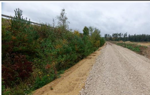
Abb. 6: Sandgraben am Böschungsfuß B85 mit Baustraße für Gewerbe-gebiet Schafhof Ost, Blick nach Nordwest
