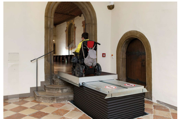
Hebelift Eingang Reichssaal
